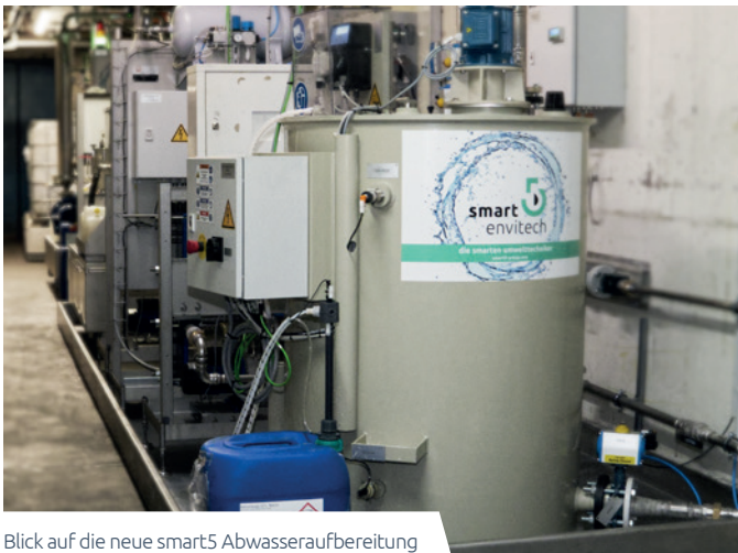
Blick auf die neue smart5 Abwasseraufbereitung
